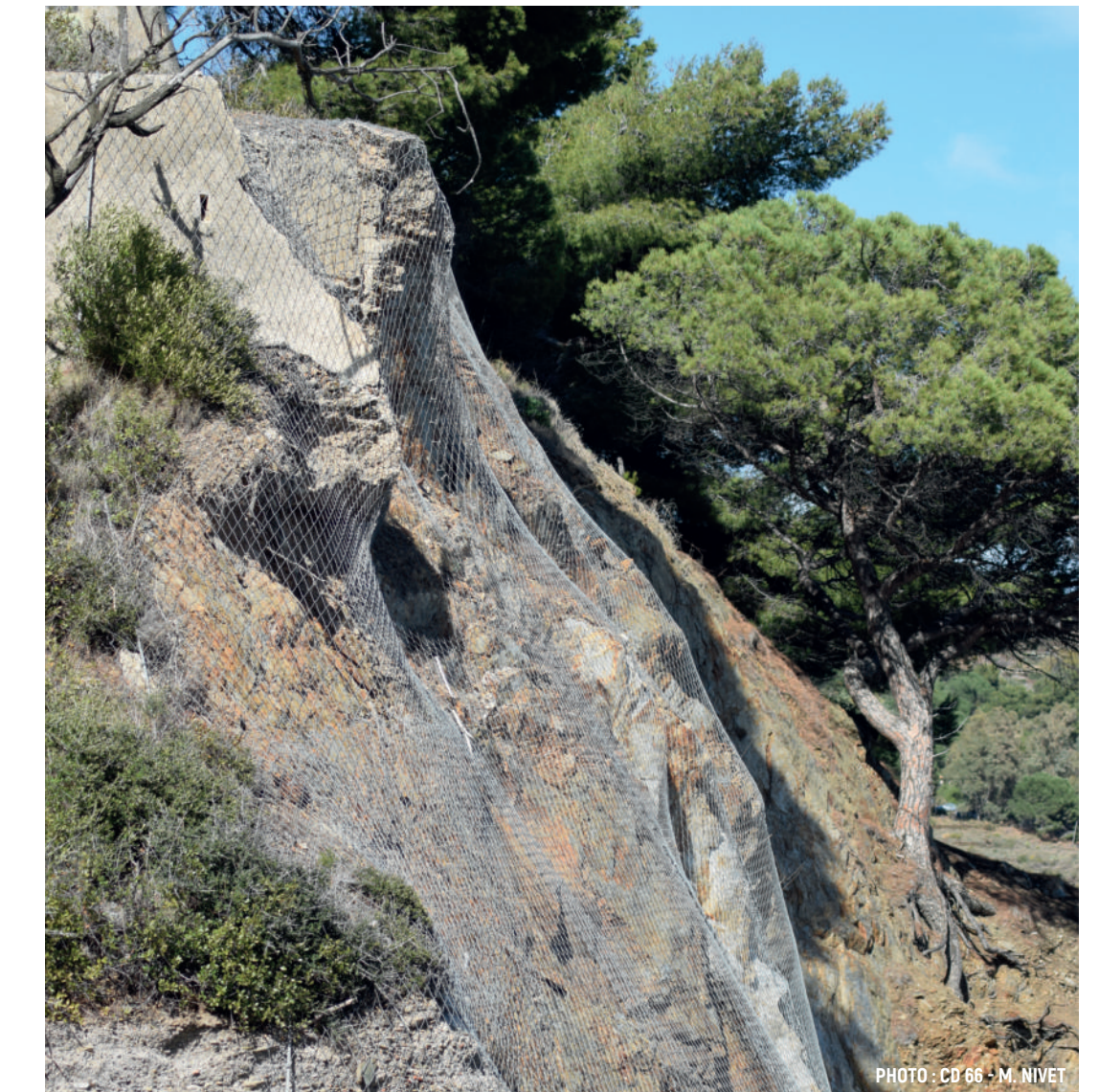
Des filets de sécurité recouvrent les falaises pour éviter les chutes de pierres. Les xarxes de seguretat cobreixen els penya-segats per evitar les caigudes de pedres. Safety netting covering the cliffs to prevent falling rocks.
