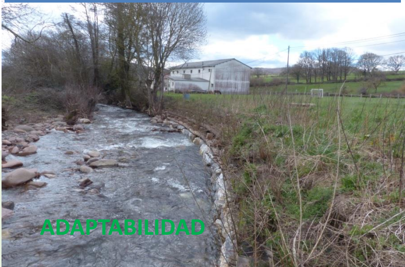
LANZ. Entramado protección tubería
