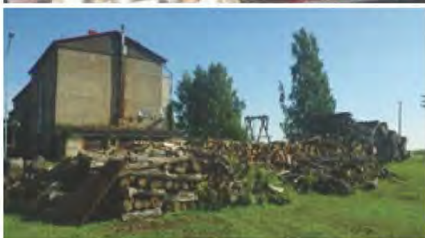
2.10. ATTĒLS: Malkas apkures katls katlu mājā "Spodras" Asares pagastā, Ancenes ciemā un malkas krāvumi nefālu no katlu mājas
