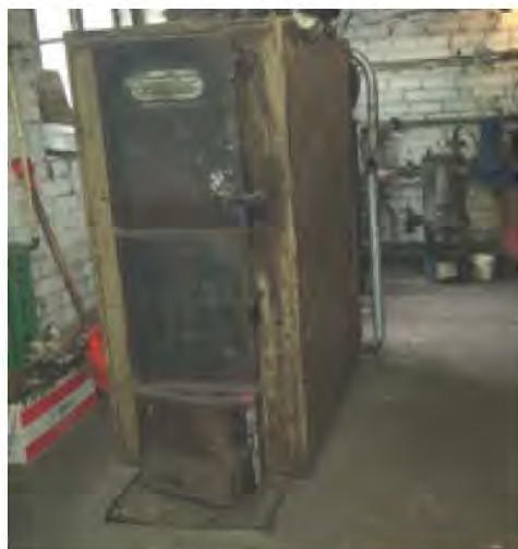
2.8. ATTĒLS: Malkas apkures katls Bēnes vidusskolā augšā, malkas apkures katls PII Vecaucece apakšā
