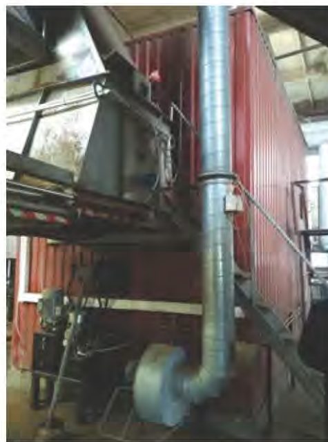
2.6. ATTĒLS: Šķeldas katls katlu mājā Tehnikas ielā 15, Aucē
