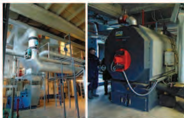
2.7. ATTĒLS: Šķeldas katls katlu mājā Bauskā (pa kreisi) un granulu katls katlu mājā Garozā (pa labi)
