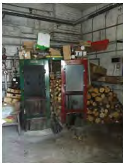
2.10. ATTĒLS: Bērzupes speciālās internātpamatskolas malkas apkures katls
