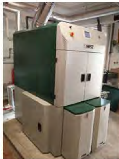
2.12. ATTĒLS: Lejasstrazdu sākumskolas granulu apkures katls
