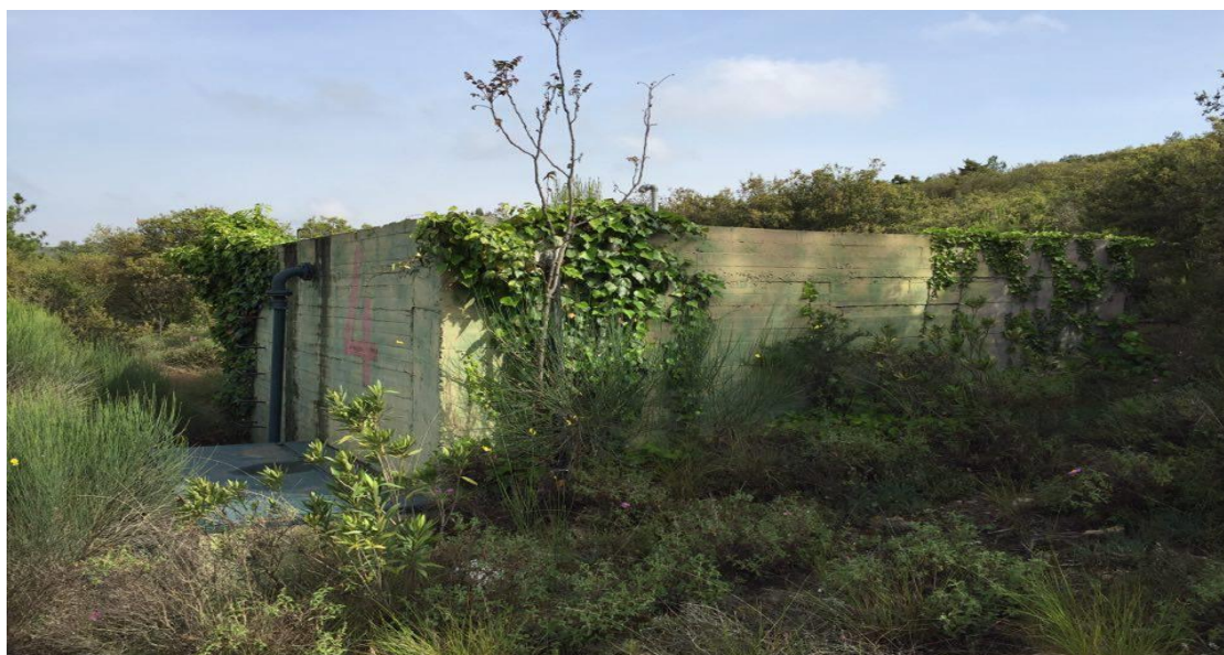
Εικόνα 8. Δεξαμενή 100 κμ αντιπυρικής προστασίας στη θέση Μονή Κοιμήσεως Θεοτόκου Πανοράματος
