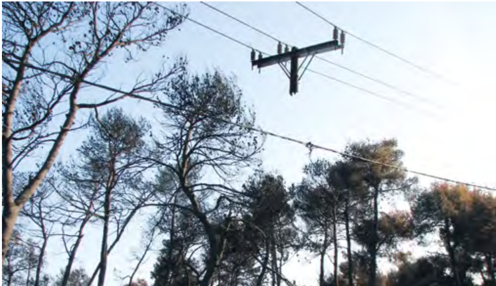
Εικόνα 7: Ένα τμήμα του στύλου του δικτύου ηλεκτροδότησης, κρέμεται από τα καλώδια ενώ το υπόλοιπο έχει καεί και έχει πέσει στο έδαφος.
