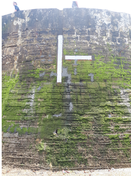
Figure 7: Positionnement des 16 capteurs sur le musoir Ouest de la digue
