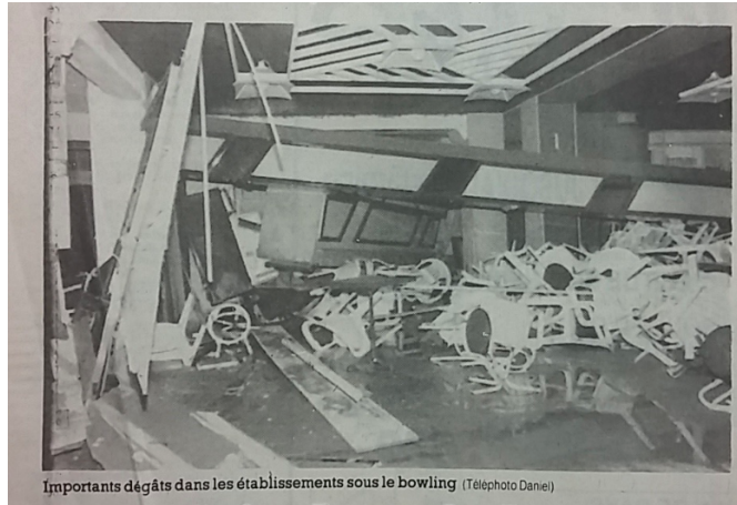
Importants dégâts dans les établissements sous le bowling (Téléphoto Daniel)
