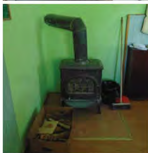
2.9. ATTĒLS: Katlu iekārta Zālītes internātpamatskolas mazajā skolā (pa kreisi) un viena no apkures krāšņim Dzintmsī pamatskolā (pa labi)
