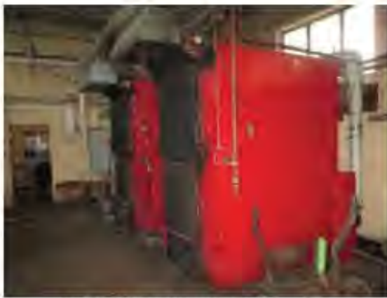
2.7. ATTĒLS: SIA "Kamfort" apkures katli.
