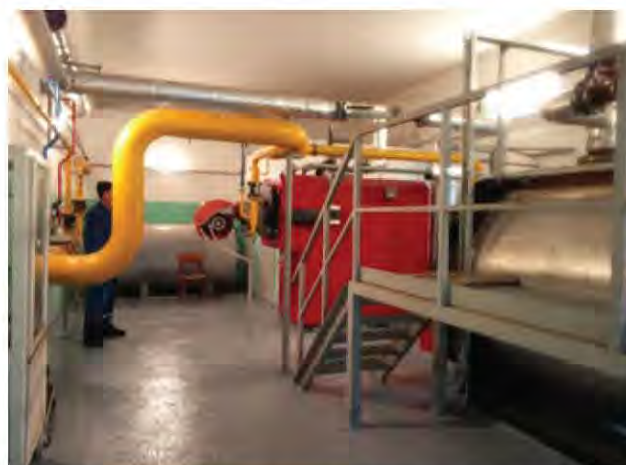
2.8. ATTĒLS: Dabasgāzes katls, katlu mājā Kalnciemā
