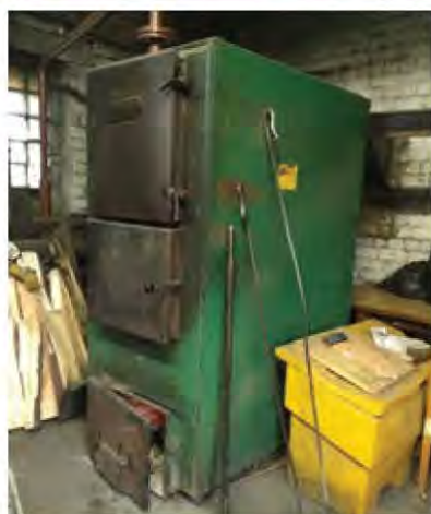
2.10. ATTĒLS: Katlu māja Jelgavas novads, Vircavas ciems, Dīķu ielā 3 (augšā), Katlu māja Valgundes pagastā, Valgundes ciemā (apakšā)
