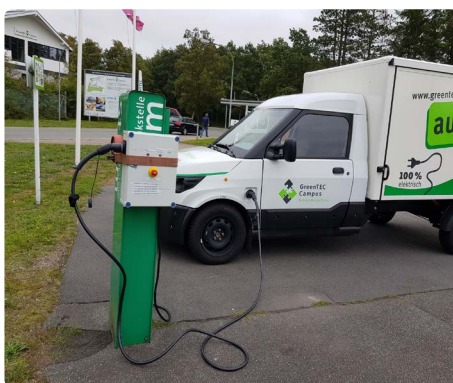
Abb. 3 Installation einer intelligenten Ladesteuereinheit am GreenTEC Campus.
