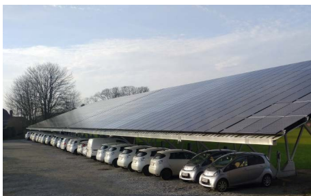
Abb. 17 Carport mit elektrischen Fahrzeugen und PV auf dem Dach.
