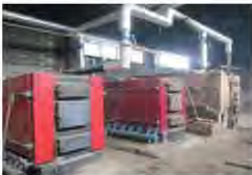
2.8. ATTĒLS: Mežāres katlu mājas ūdenssildāmie katli
