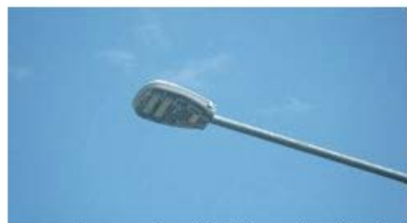
2.25. ATTĒLS: LED gaismekis vienā no Pļaviņu pilsētas ielu apgaismojuma posmiem
