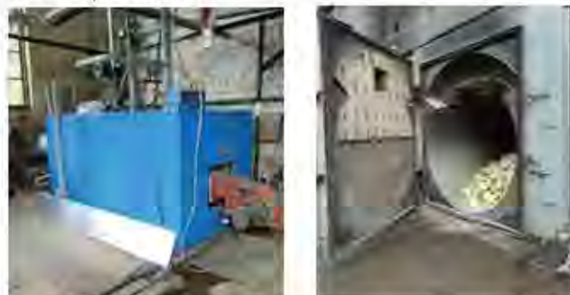
2.6. ATTĒLS: Dabas gāzes katls katlu mājā Pilsrundālē (pa kreisi) un biomasas katlu māja Saulainē (pa labi)
