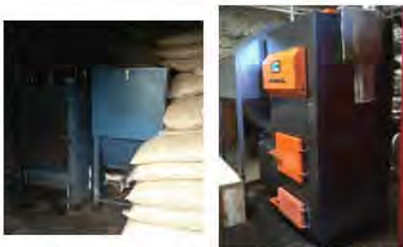
2.8. ATTĒLS: Granulu katls Augstkalnes pagasta pārvaldē pa kreisi, Granulu katls Tērvetes novada domē pa labi.
