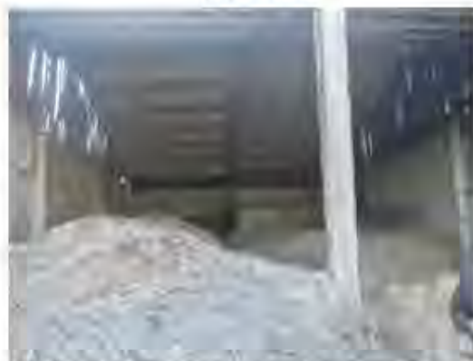
2.6. ATTĒLS: Šķeldas novietne katlu mājā Viesītes pilsētā, Smilšu ielā 39B
