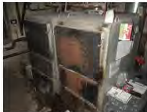
2.9. ATTĒLS: Malkas katli Brīvības ielā 12 esošajā katlu mājā
