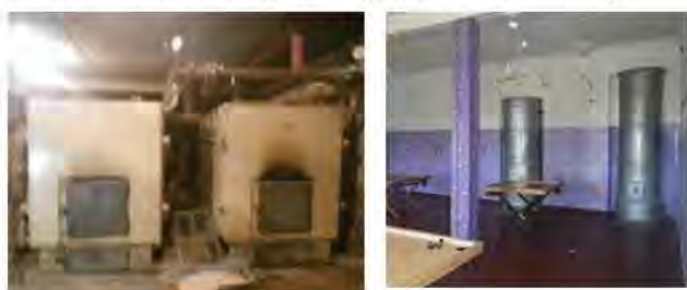
2.14. ATTĒLS: Malkas apkures katli Viesītes kultūras pilī (pa kreisi) un krāšņu apkure slēgtajā Elkšņu skolā (pa labi)
