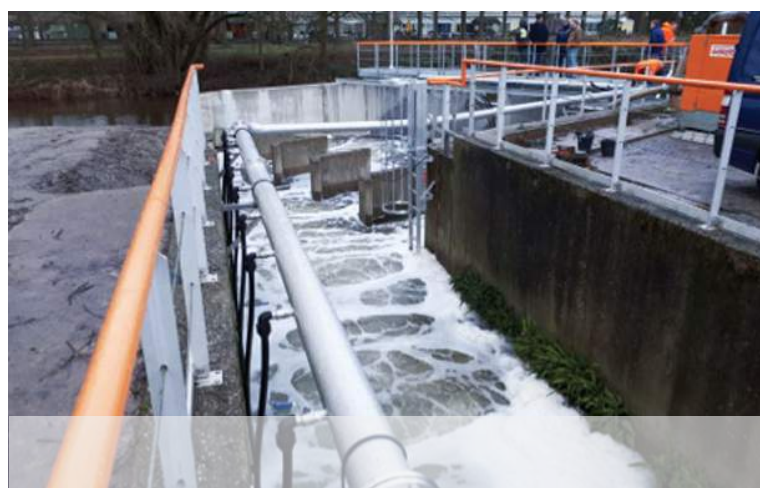
Figuur 29 De effluentbeluchting in werking
