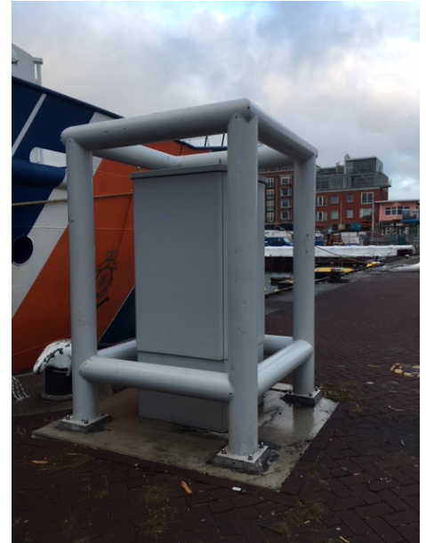
Figuur 2 walstroompunt van ongeveer 3 meter hoog
