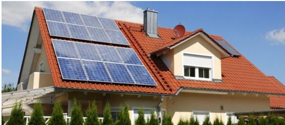
Φωτό 2. Φωτοβολταϊκό σύστημα σε στέγη κτιρίου.
