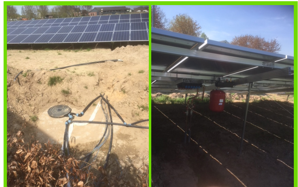
Die Bilder zeigen, wie die Komponenten im Untergrund und im Kniestock angebracht werden.
