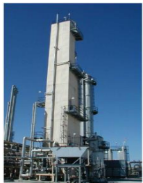
Small liquefaction Bio LNG
