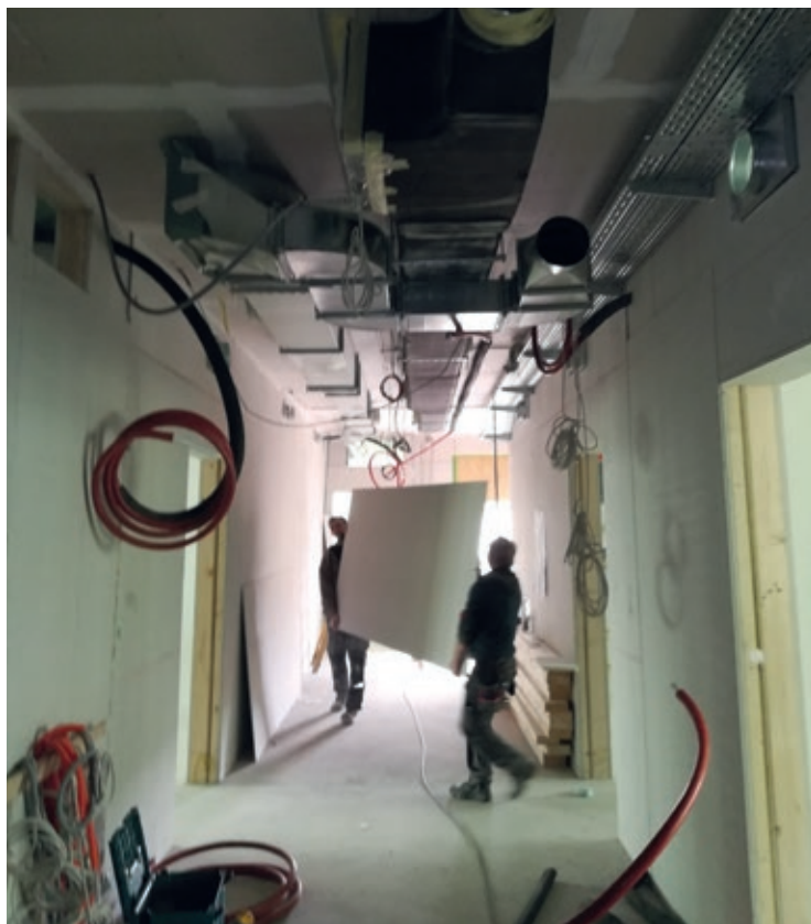
Potek strojnih instalacij v hodniku prizidka
