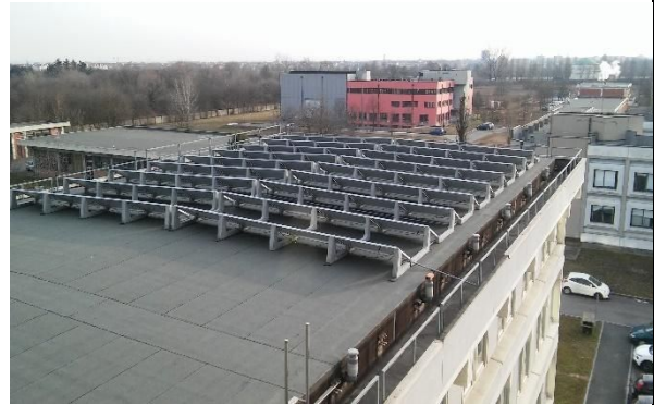
Immagine della copertura piana e dell'impianto FV installato
