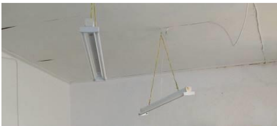
Εικόνα 13: Τυπικό φωτιστικό σώματα
