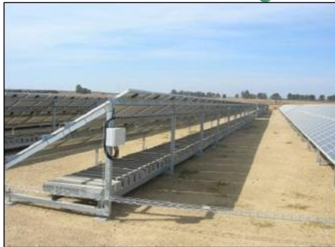
Ilustración 13. Imagen de una instalación fotovoltaica estática
