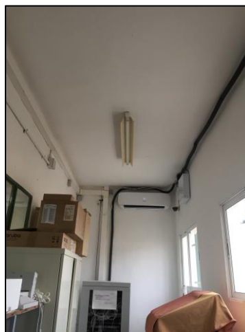
Ilustración 4. Unidad interior de refrigeración sala rack
