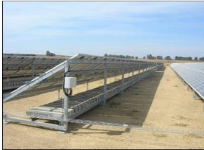
Ilustración 14. Imagen de una instalación fotovoltaica estática
