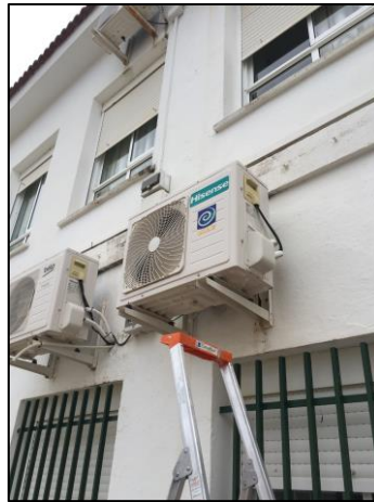
Ilustración 3. Unidad exterior de climatización
