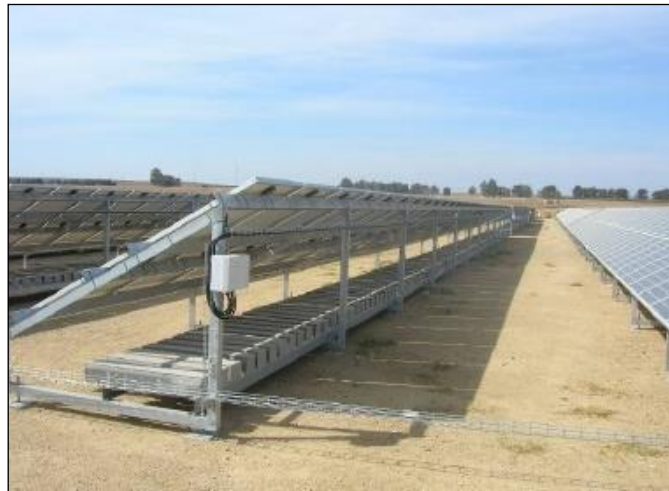
Ilustración 14. Imagen de una instalación fotovoltaica estática
