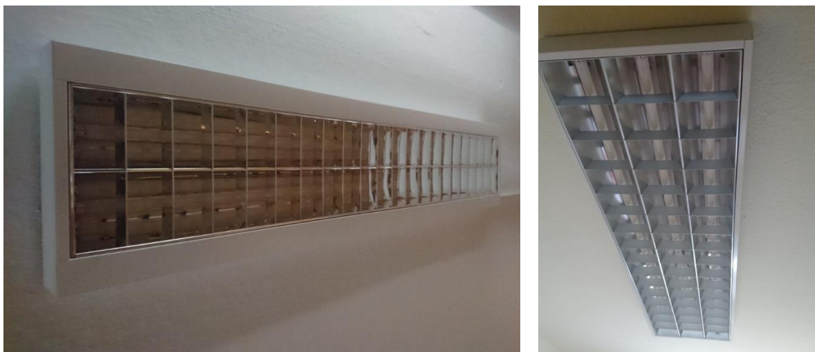
Slika 32: Prenovljena osvetlitev kleti (samo en prostor – levo) in razsvetljava v pisarnah.
