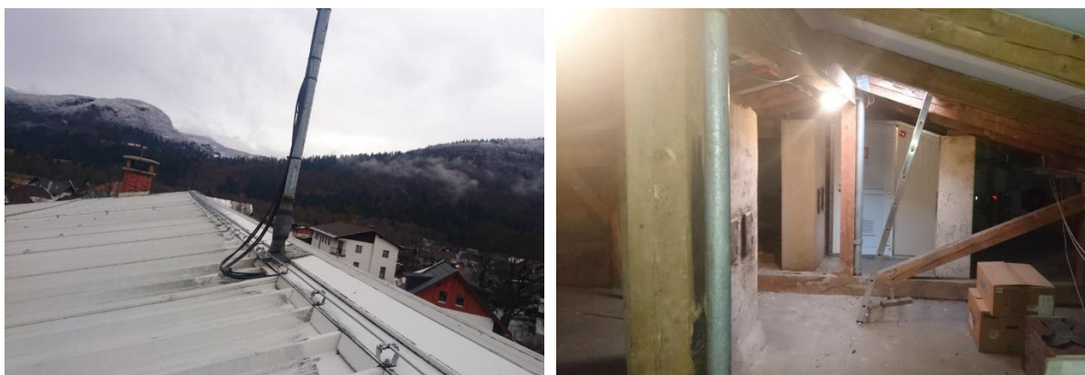
Slika 34: Pločevinasta streha in neizolirano podstrešje.
