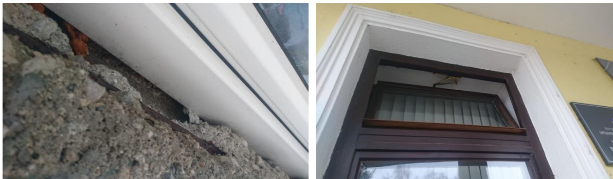
Slika 35: Neustrezno tesnjenje med okenskim okvirjem in špaleta v kleti (levo) in leseno vezano okno v pritličju.
