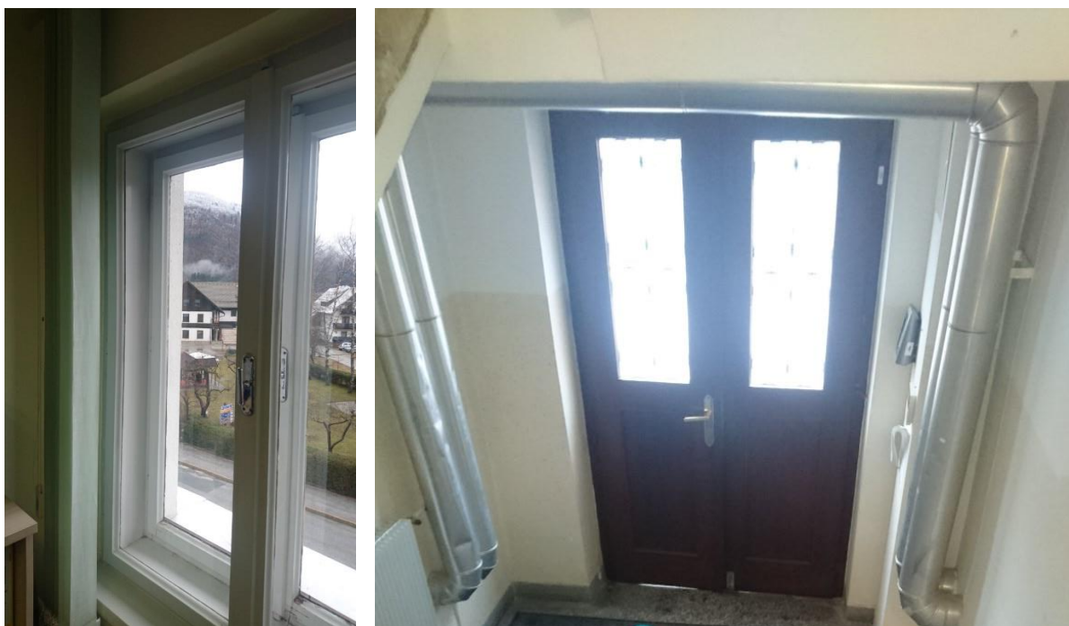
Slika 36: Škatlasta okna v nadstropjih in neustrezno tesnjenje vrat na JZ.
