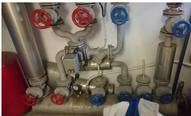
Slika 29: Zastareli in deloma neizolirani elementi ogrevalnega sistema.
