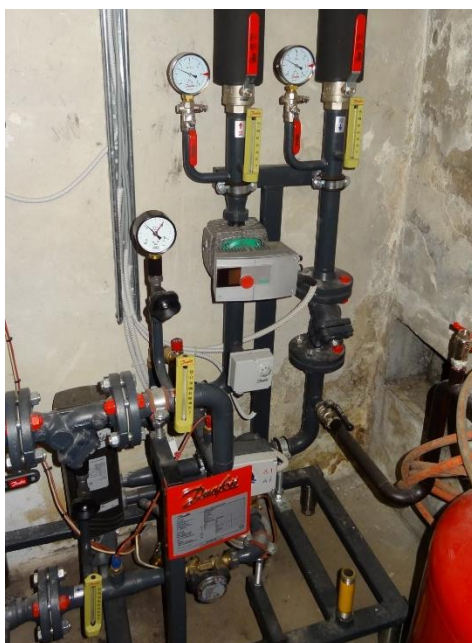
Slika 39: Toplotna postaja v Občinski stavbi Bohinj.
