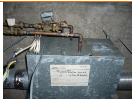
Batteries chaudes de la CTA (prétraitement air neuf)
