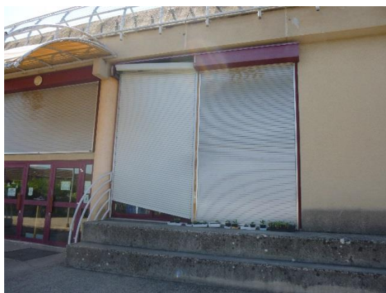
Volets abîmés au rez-de-chaussée
