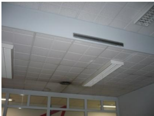
Bouche de CTA dans salle de classe
