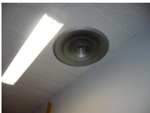
Bouche de soufflage
