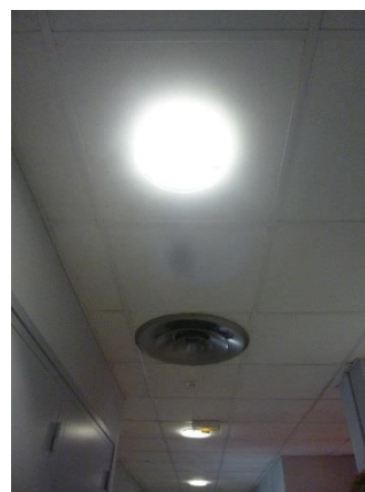
Lampes fluocompactes dans les circulations
