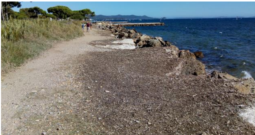
Figura 24: Evoluzione della sezione disaccoppiata al punto 8 (dall'alto verso il basso: settembre 2019 prima dei lavori; novembre 2019: dopo i lavori e le tempeste)
