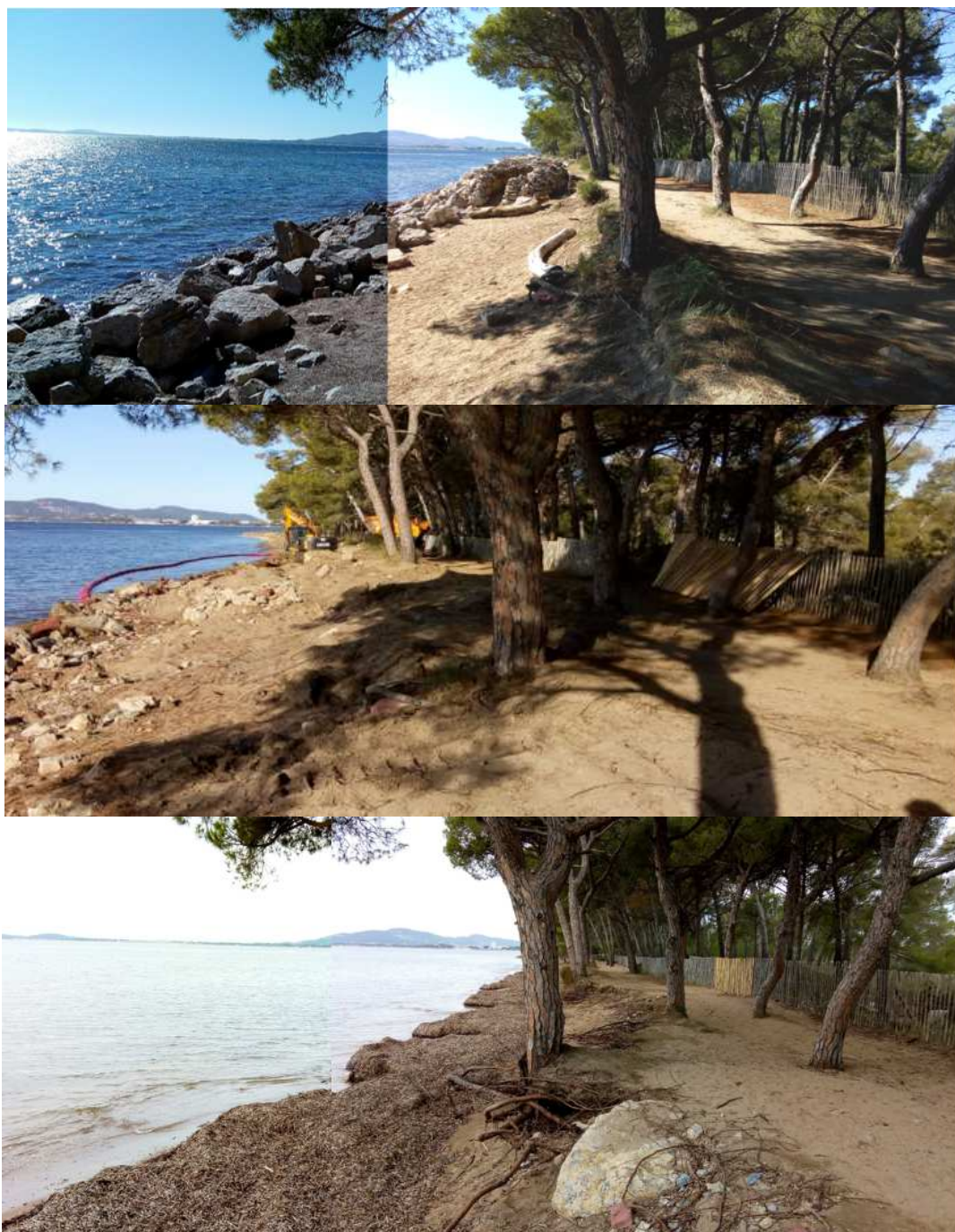
Figure 23 : Evolution du tronçon désenroché au point 6 (de haut en bas : septembre 2019 avant travaux; octobre 2019 : pendant travaux ; novembre 2019 : après travaux et tempêtes)
