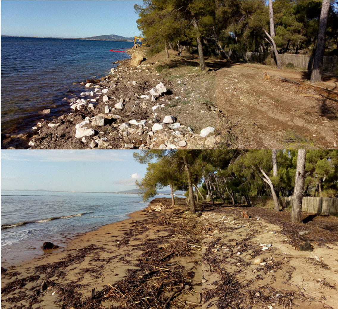
Figure 22 : Evolution du tronçon désenroché au point 5 (de haut en bas : septembre 2019 avant travaux; octobre 2019 : pendant travaux ; 24 octobre 2019 : après travaux et tempête)
