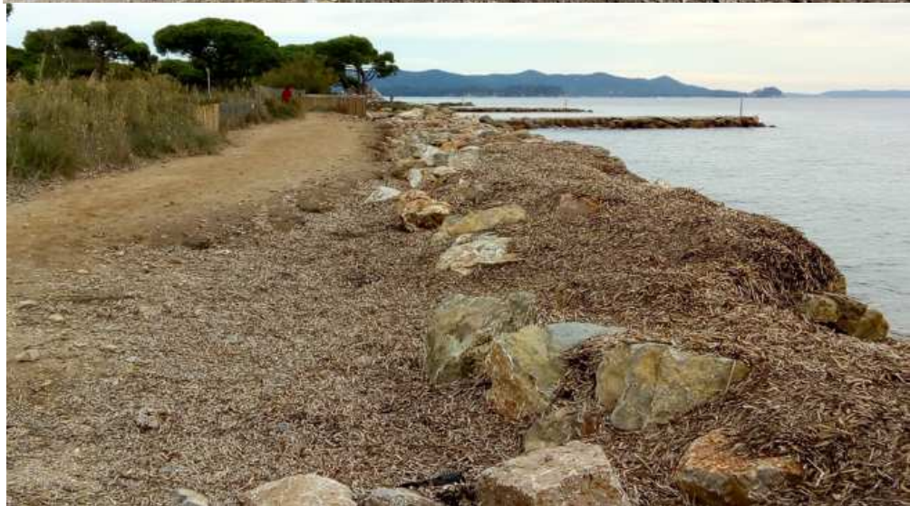
Figure 26 : Evolution du tronçon de maintien des enrochements au point 9 (de haut en bas : septembre 2019 avant travaux; novembre 2019 : après travaux et tempête)
