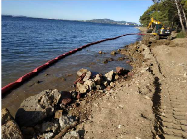
Figure 14 : Barrage anti-décontamination déployé pendant les travaux de désenrochement aux Vieux Salins d'Hyères (2019)
