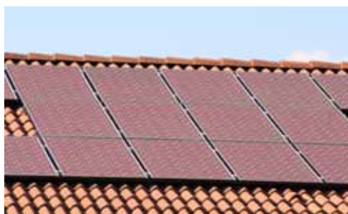
Figura 10: Impianto fotovoltaico con pannelli colore rosso mattone per ridurre l'impatto paesaggistico
