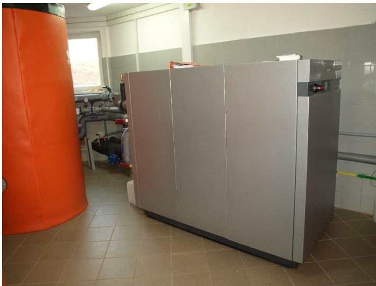
Fot. 5. Gruntowa pompa ciepła Viessman Vitocal 300-G PRO
