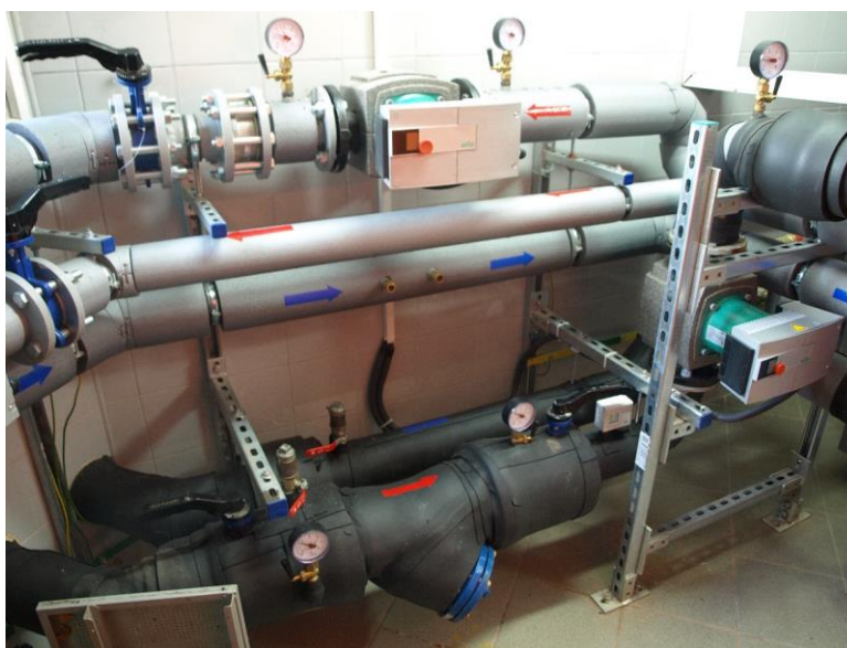
Fot. 6. Instalacja systemu geotermii niskotemperaturowej. Widoczne pompy obiegu.
