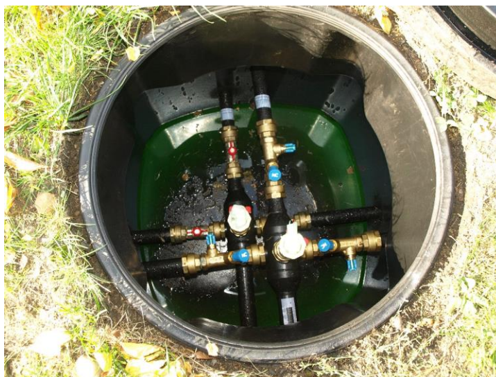
Fot. 2. Studzienka zbiorcza otworowych wymienników ciepła.
