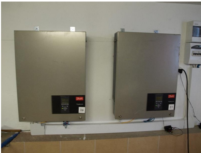
Fot. 9. Inwertery instalacji fotowoltaicznej PV sprzężone z systemem gruntowej pompy ciepła oraz instalacją ogrzewającą ciepłą wodę użytkową.
