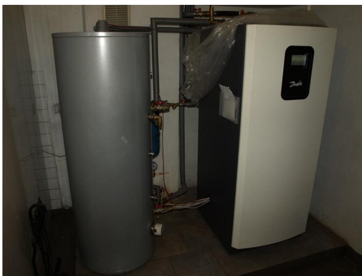
Fot. 3. Gruntowa pompa ciepła Danfoss oraz zbiornik c.w.u.
