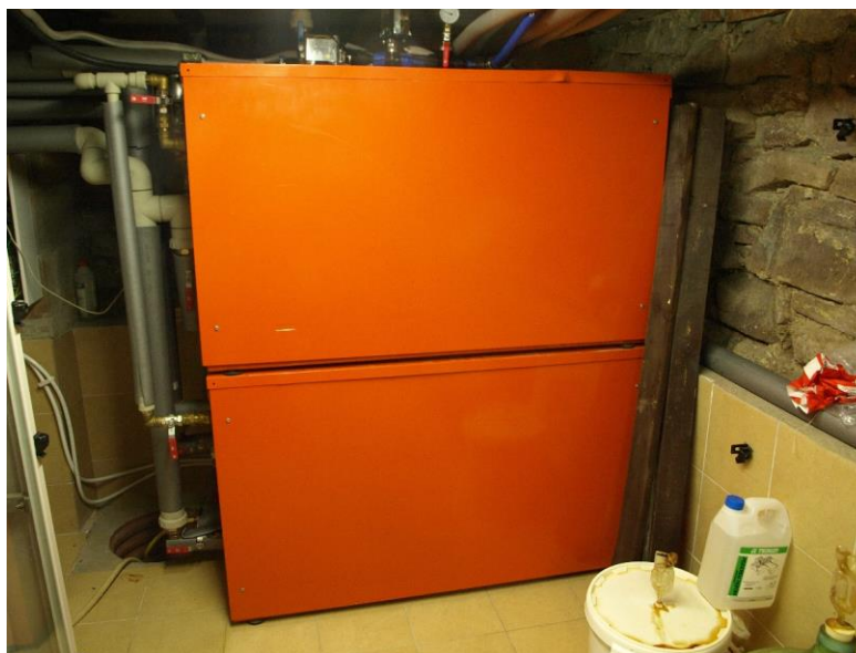
Fot. 10. Zbiorniki na ciepłą wodę użytkową zasilane energią elektryczną z ogniw fotowoltaicznych.
