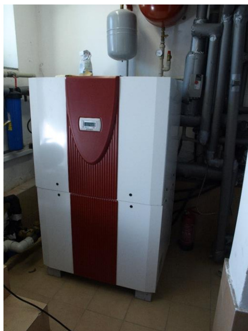
Fot. 8. Gruntowa pompa ciepła Dimplex.
