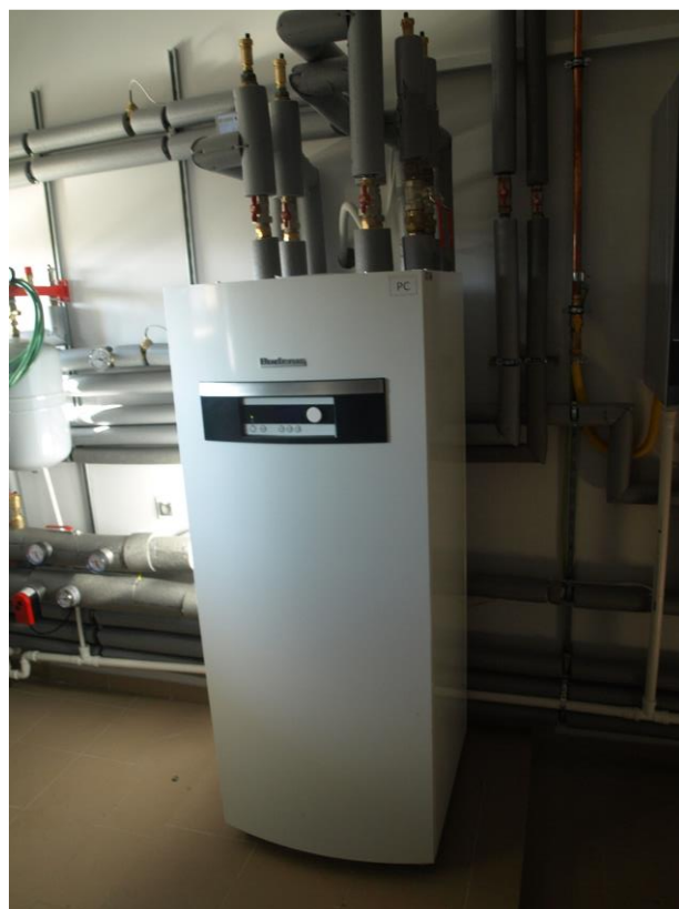
Fot. 12. Gruntowa pompa ciepła Buderus.
