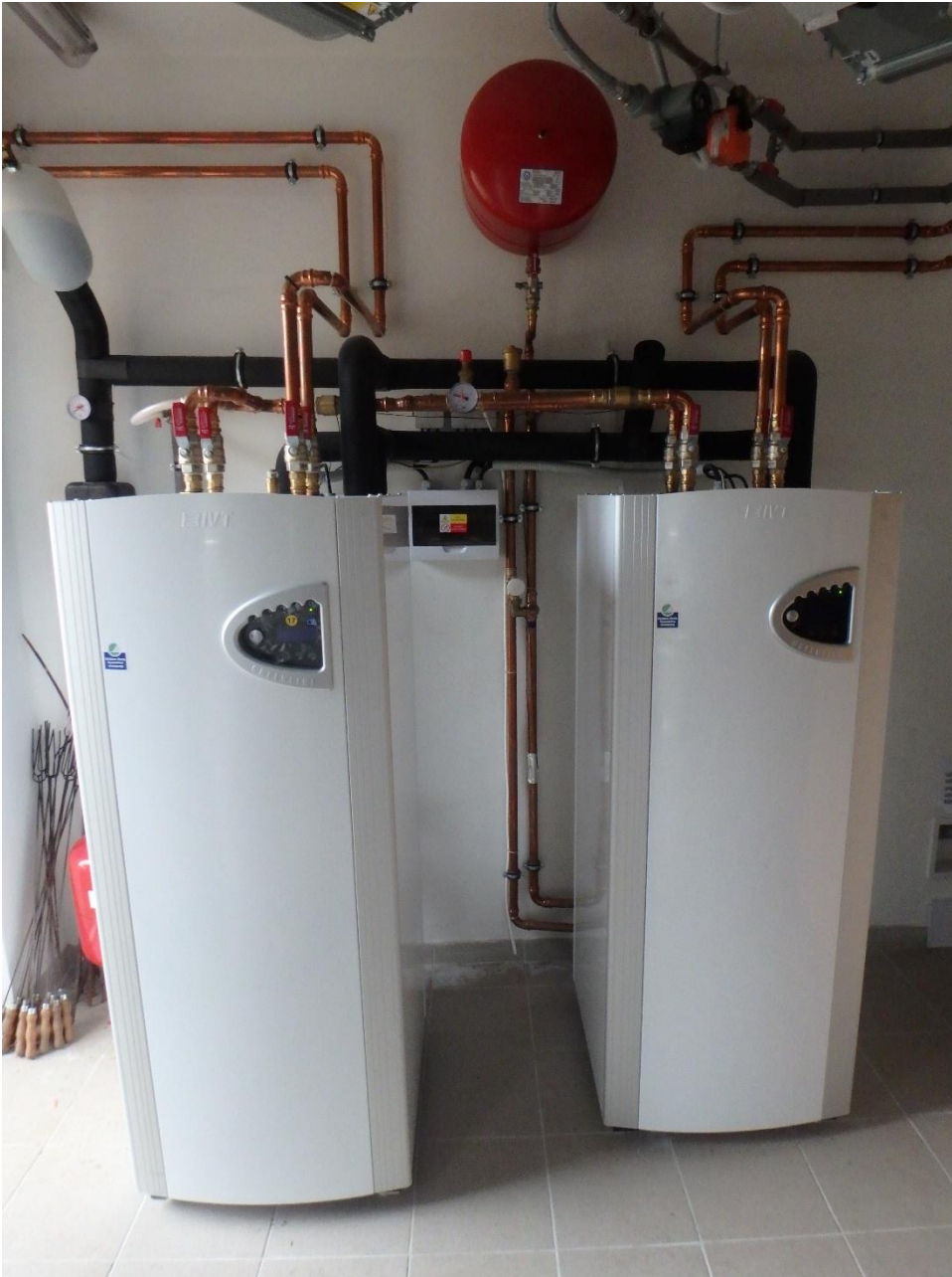
Obr. 13 Technologie tepelného čerpadla je umístěna v technickém zázemí budovy kempu
