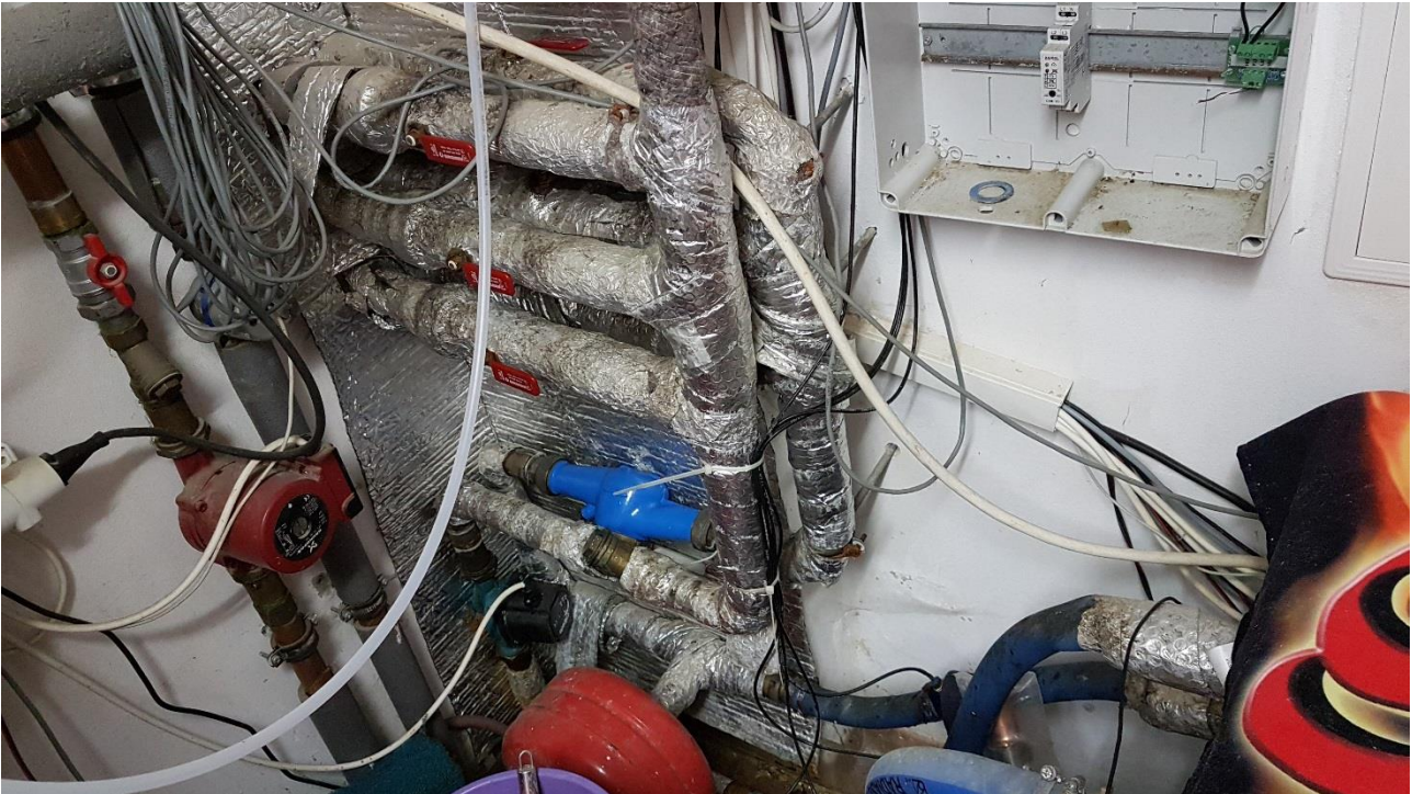
Obr. 7 Výměník tepelného čerpadla
