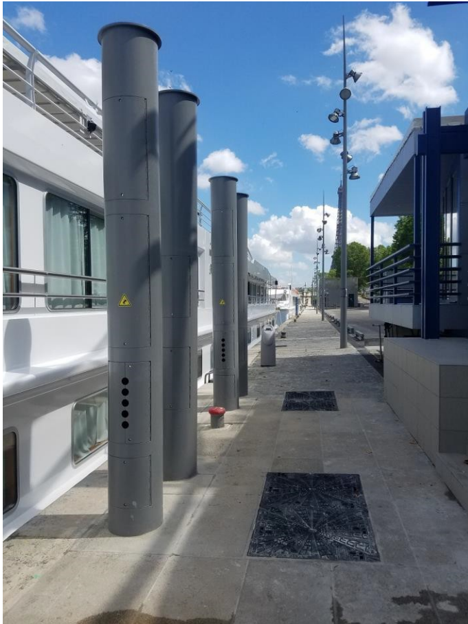
Bornes d'alimentation électrique
