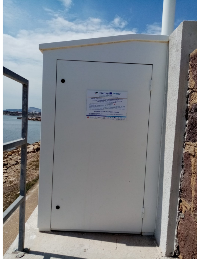
Figura 4. vista shelter chiuso Porto Torres
