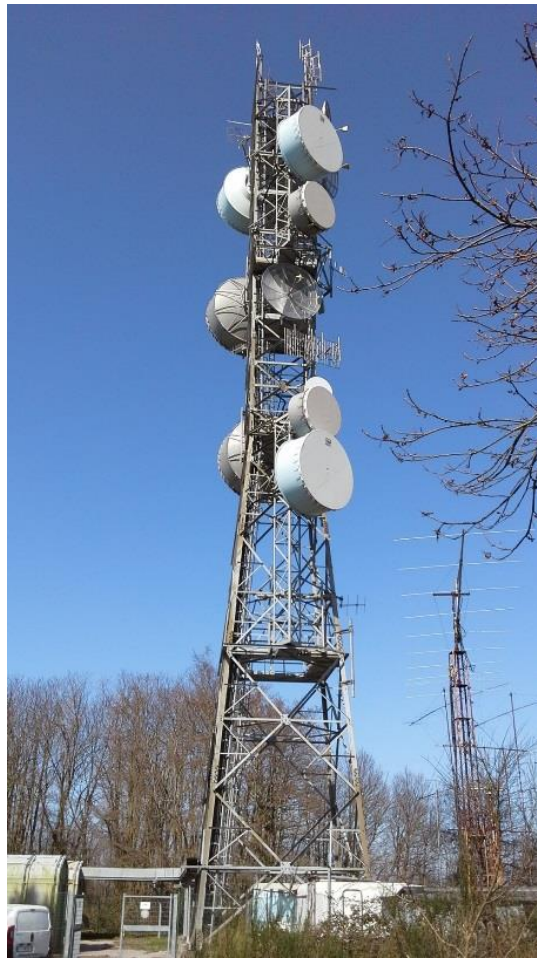
Fig. 2 - Traliccio 40m di Monte Verrugoli
