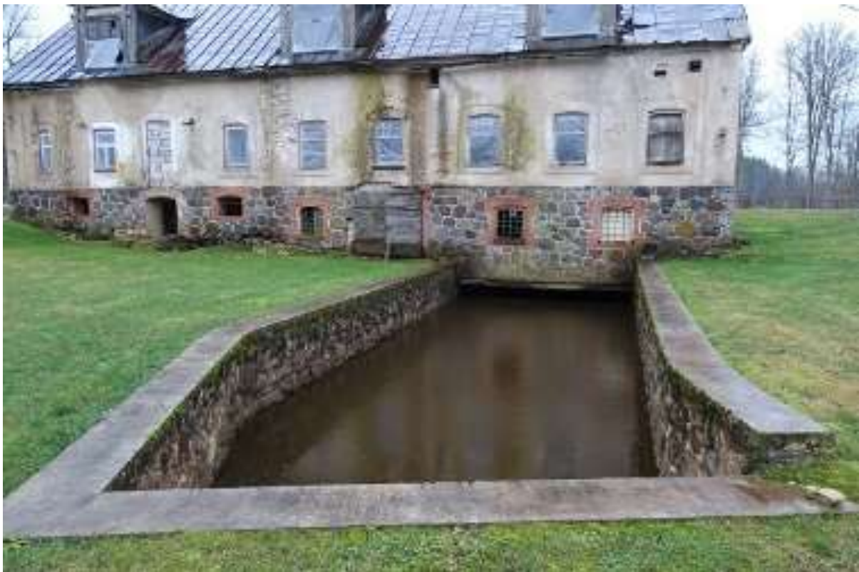
Foto 11. Turbiini väljavoolukanali avaosa pikkus on ca 15 m. Seejärel jätkub kanal maa-aluse toruna kuni jõeni (R. Järvekülg, 10.12.2019).
