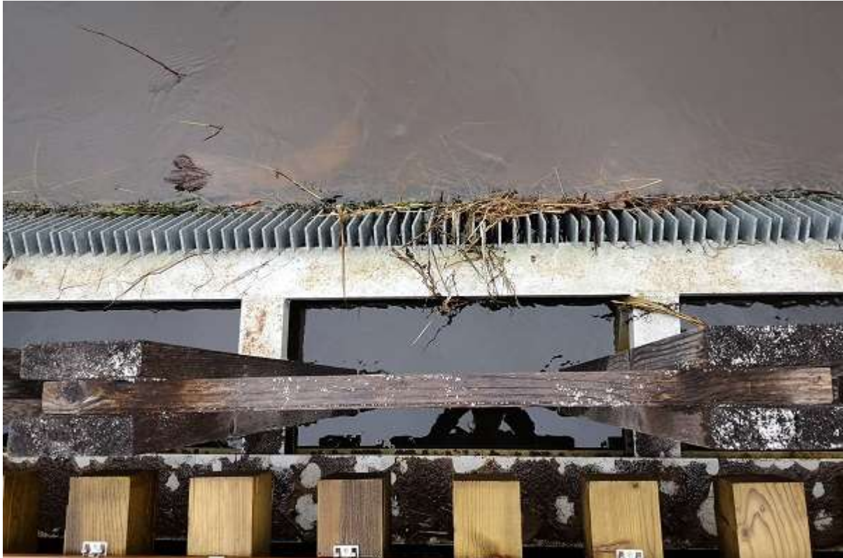
Foto 10. Turbiinikanali sissevoolul olev võre tuleks asendada tihedama ning konstruktsioonilt tugevamaga. Praegu on osaliselt deformeerunud võre avad 22...30 mm (R. Järvekülg, 10.12.2019).
