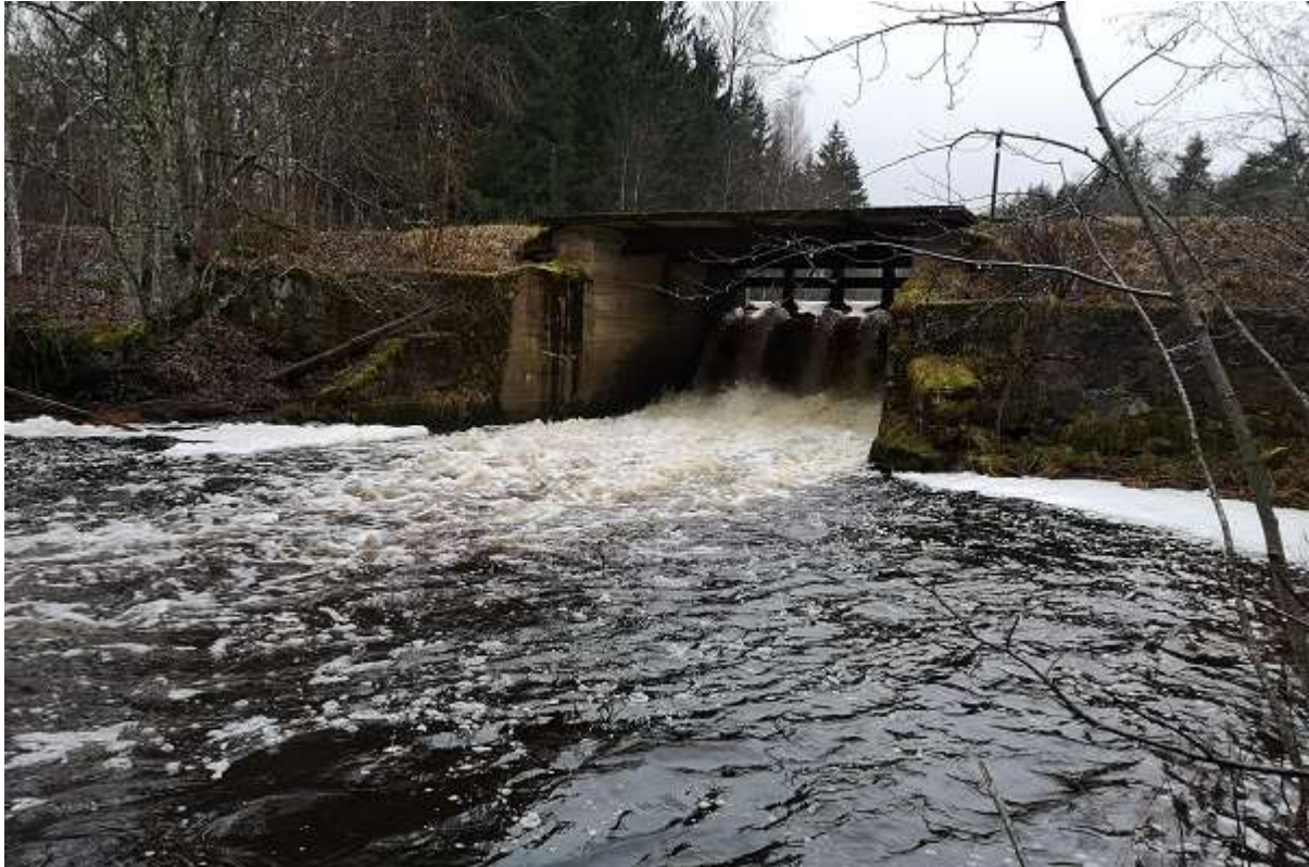
Foto 23. Pärlijõe paisu paisutuskõrgus on 2,8...2,9 m. Kalapääsu rajamine on võimalik juhul kui paisu kõrgust alandada \frac{1}{2} võrra. Kuna paisu juures püsielamine puudub, siis on pidevaks ohuks see, et jõe vooluhulkade tõustes pole kedagi, kes õigeaegselt paisult varje eemaldaks (R. Järvekül, 10.12.2019).
