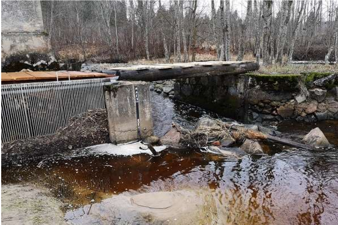
Foto 9. Turbiini ja kalapääsu sissevoolude vahel oleva betoonposti on algeline mõõdulatt, kuhu on 0,5 m vahega märgitud normaal- ja maksimaalpaisutuse tasemed. Vaatluspäeval oli ülavee tase 0,2 m allpool NPT-d. On kaheldav, kas mõõdulati paigaldamisel on osalenud ka geodeet. Pigem on paisu omanik märkinud latile talle sobivana tunduvad kõrgused (R. Järvekülg, 10.12.2019).
