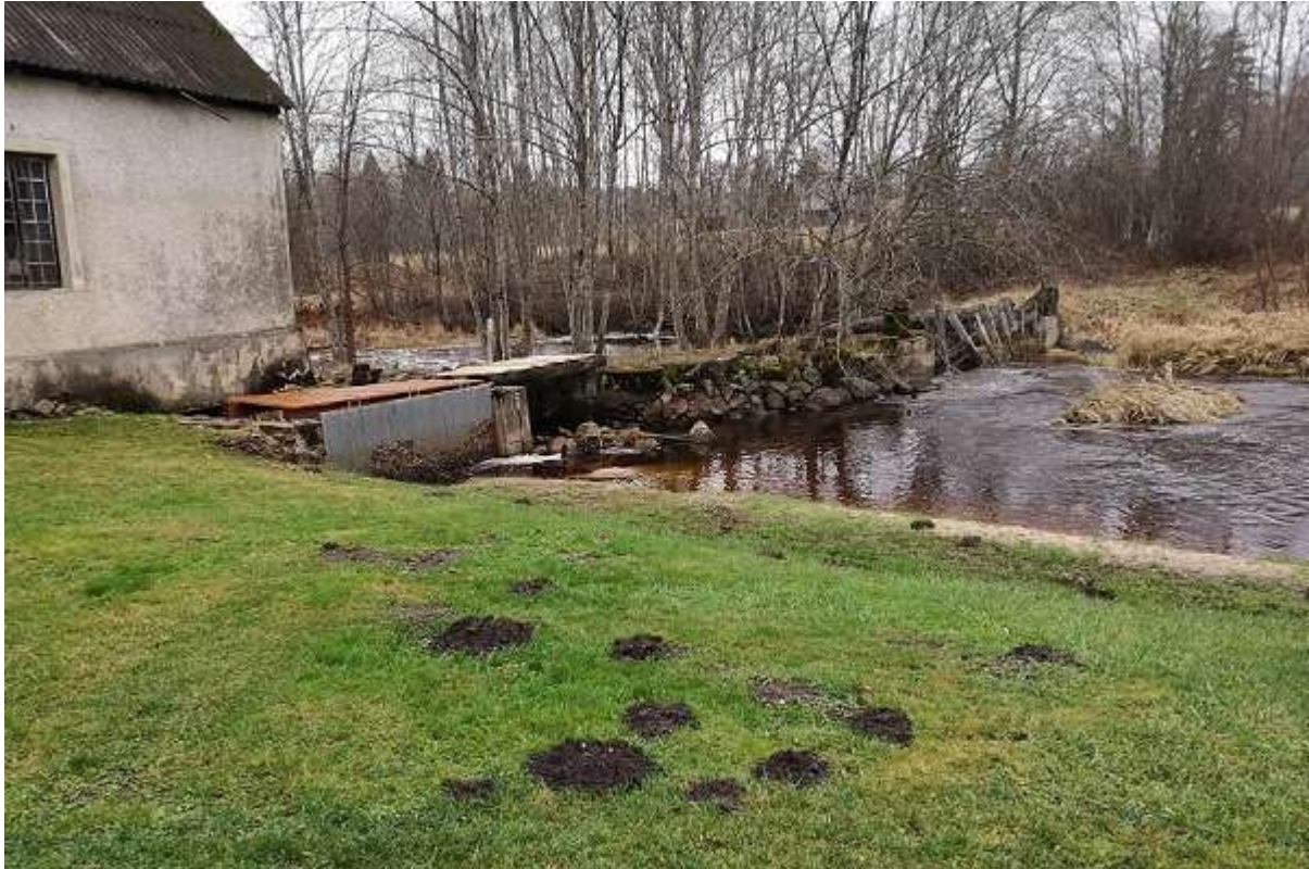
Foto 8. Vaade Ala-Raudsepa (Kaugu) paisule ülavee poolt. Vasakul turbiinikanali sissevool võrega, selle kõrval kalapääsu sissevool, järgneb kividega kindlustatud pinnaspaisu osa ja seejärel jõe paremas servas liigveelase (R. Järvekülg, 10.12.2019).
