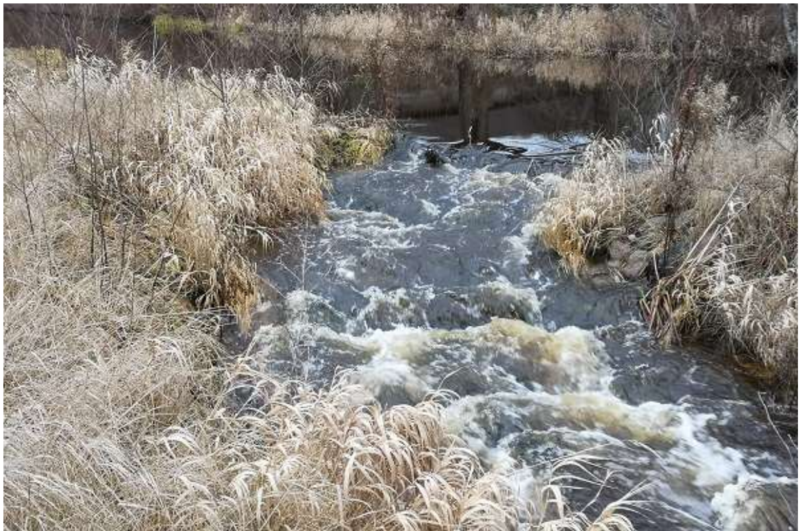
Foto 7. Kalapääsu sissevool – jällegi suure languga ja kivide paigutus vajab korrigeerimist. Kokkuvõtlikult on Sänna Mäeveski kalapääs kaladele praegu raskesti läbitav. Seda suudavad läbida ainult vähesed hea ujumisvõimega kalad. Kalapääs vajab korrigeerimist ning seejärel tuleb läbi viia seire, mis näitab kas sellest piisas või on vajalikud ka ulatuslikumad ümberehitustööd (R. Järvekülg, 10.12.2019).
