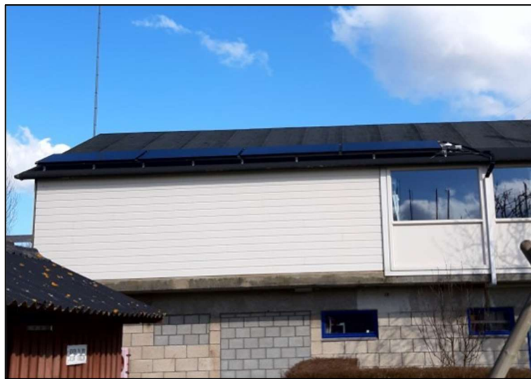
Figure 4.1 PVT-collectors placed at WSV Haringvliet (Hellevoetsluis), (Romijn, 2021)
