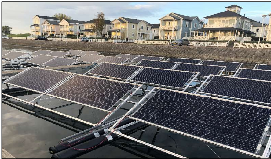
Figure 3.1 Floating Solar Panels at Marina Cape Helius (Hellevoetsluis) (Berg, 2021)
