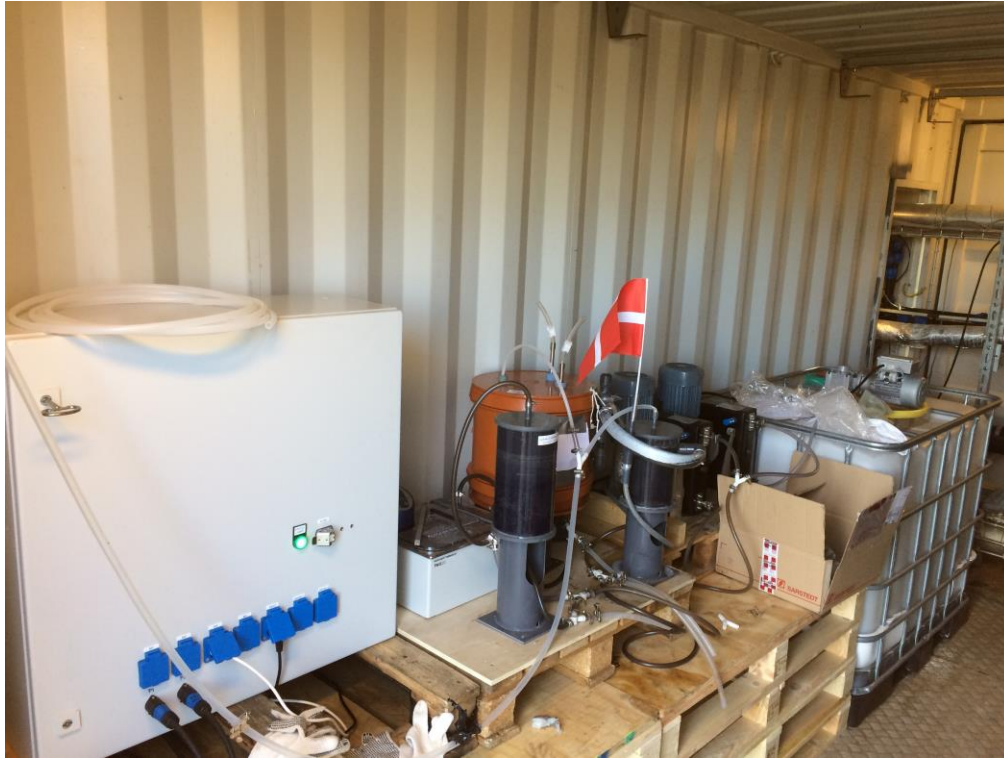
Opstillingen af forsøgsanlægget i container hos Thise Mejeri.
