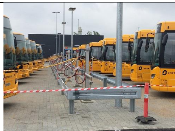
Slow-fill gasfyldestation i Sønderborg.
