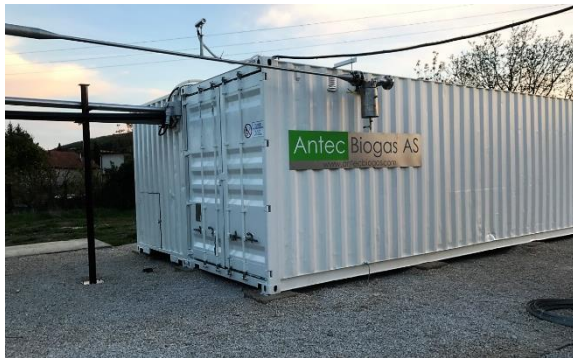
Figur 3: Antec biogassanlegg i to containere (Andersen, 2017)
