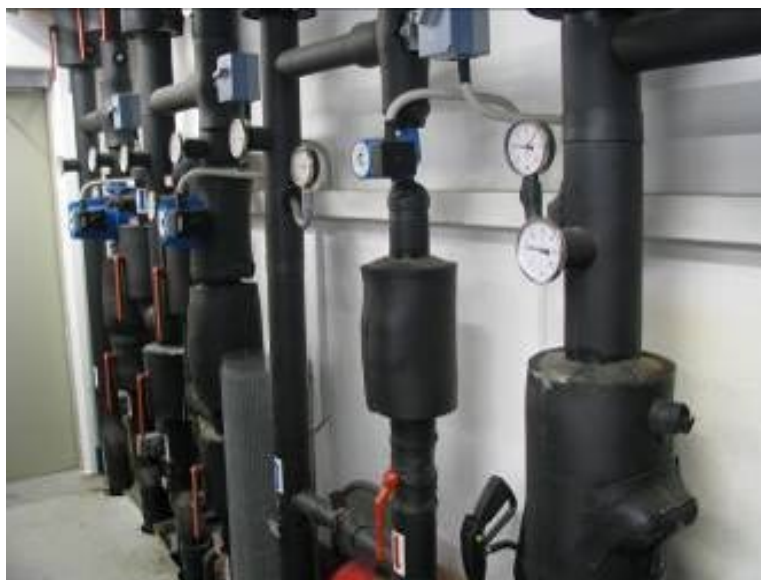
Figura 6.5: distributore moderno di acqua calda
