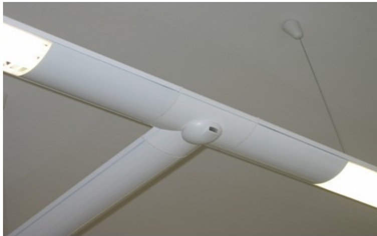
Figura 6.7: illuminazione fluorescente moderna con controllo DALI
