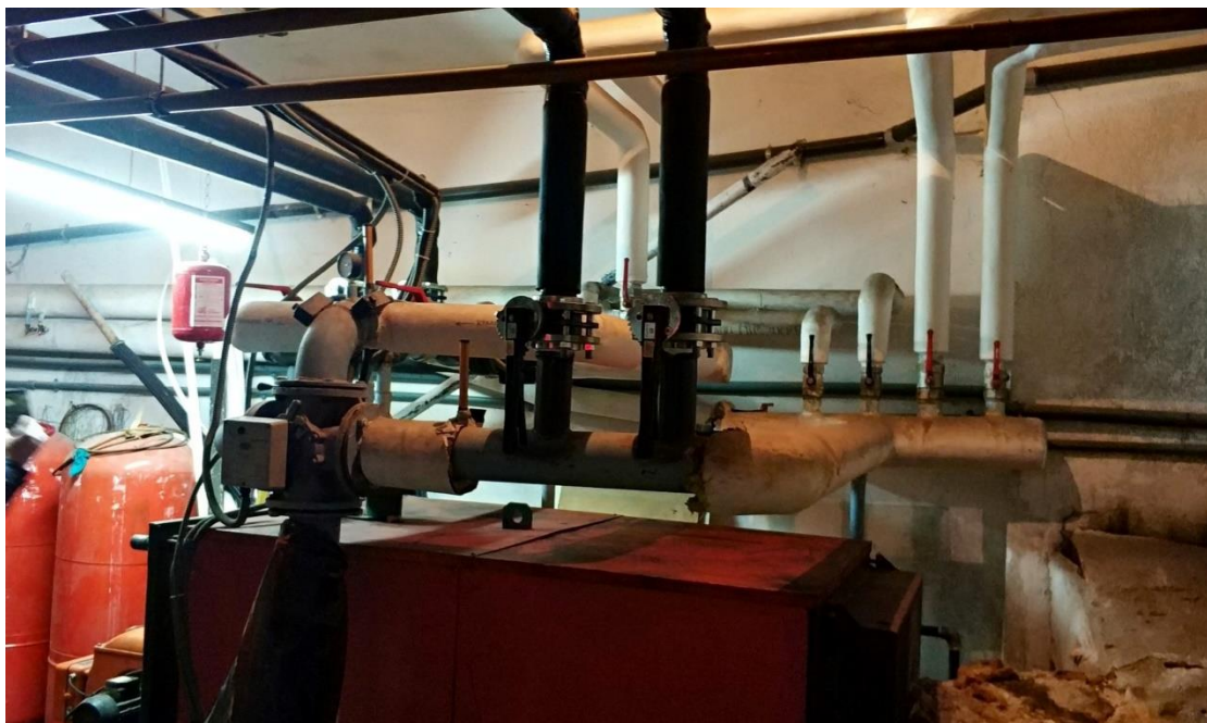
Εικόνα 1.Υφιστάμενο λεβητοστάσιο στο υπόγειο του κτιρίου Β
