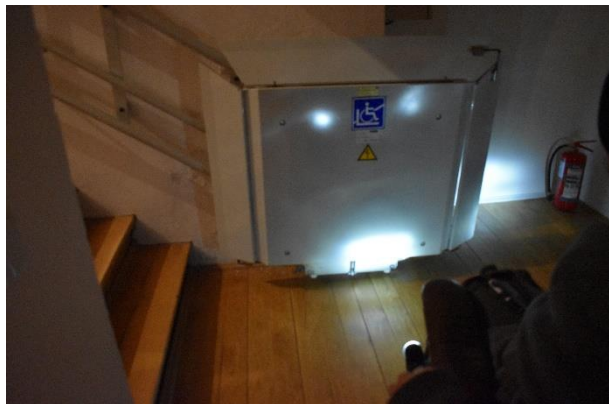
neispravna podizna platforma
