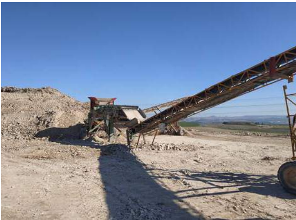
Figura 120. Cinta transportadora que sirve para el cribado del acopio de árido reciclado mixto
