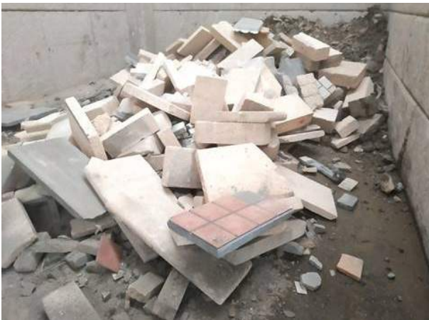
Figura 97. Escombros acopiados para su valorización Fuente: GAN-NIK
