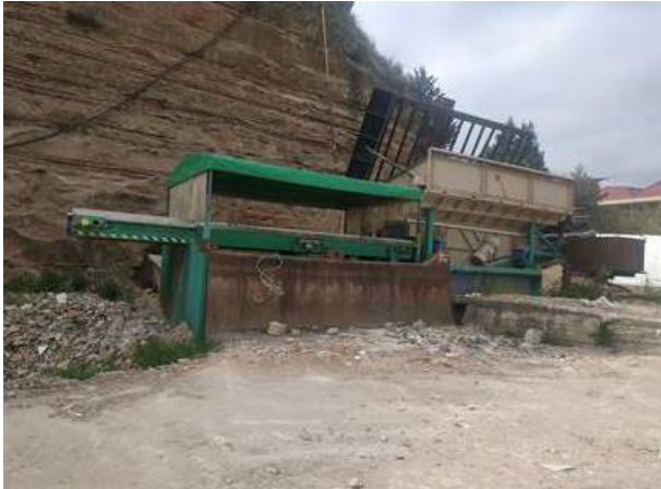
Figura 91. Instalación de cribado con cadena de triaje Azanza
