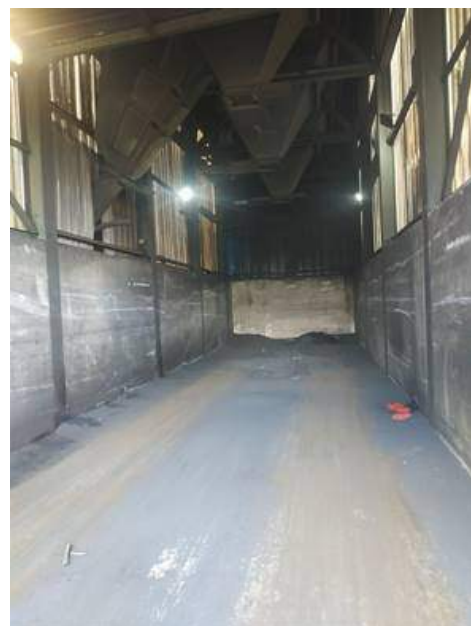
Figura 107. Detalles de las salidas de los silos que almacena la arena residual.
