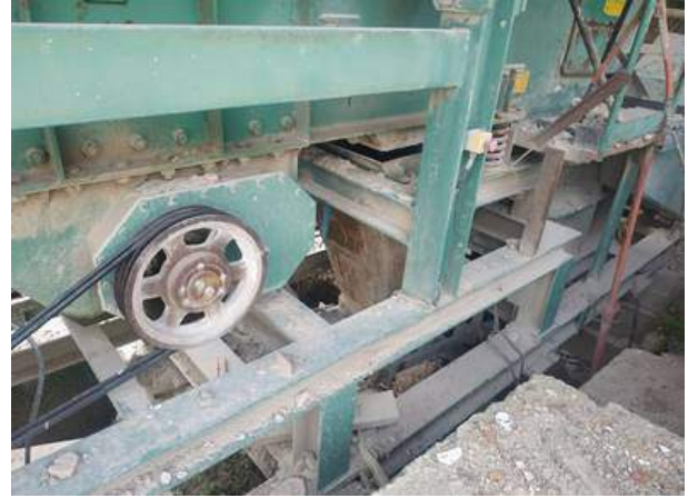
Figura 92. Detalle de la instalación de reciclaje Azanza
