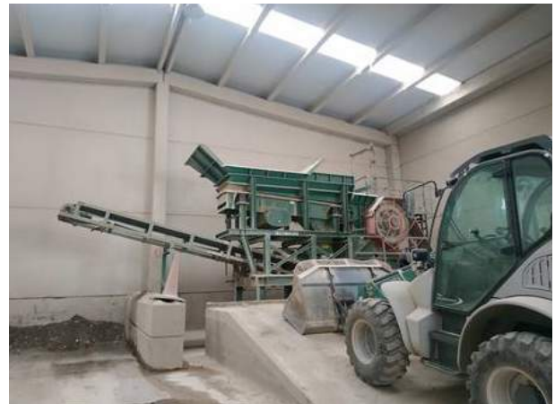
Figura 98. Instalación junto a la pala cargadora. Fuente: GAN-NIK
