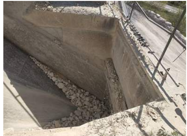
Figura 82. Tolva de áridos
