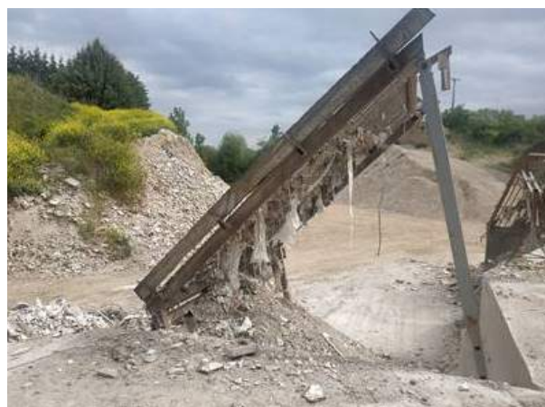
Figura 89. Sistema de cribado
