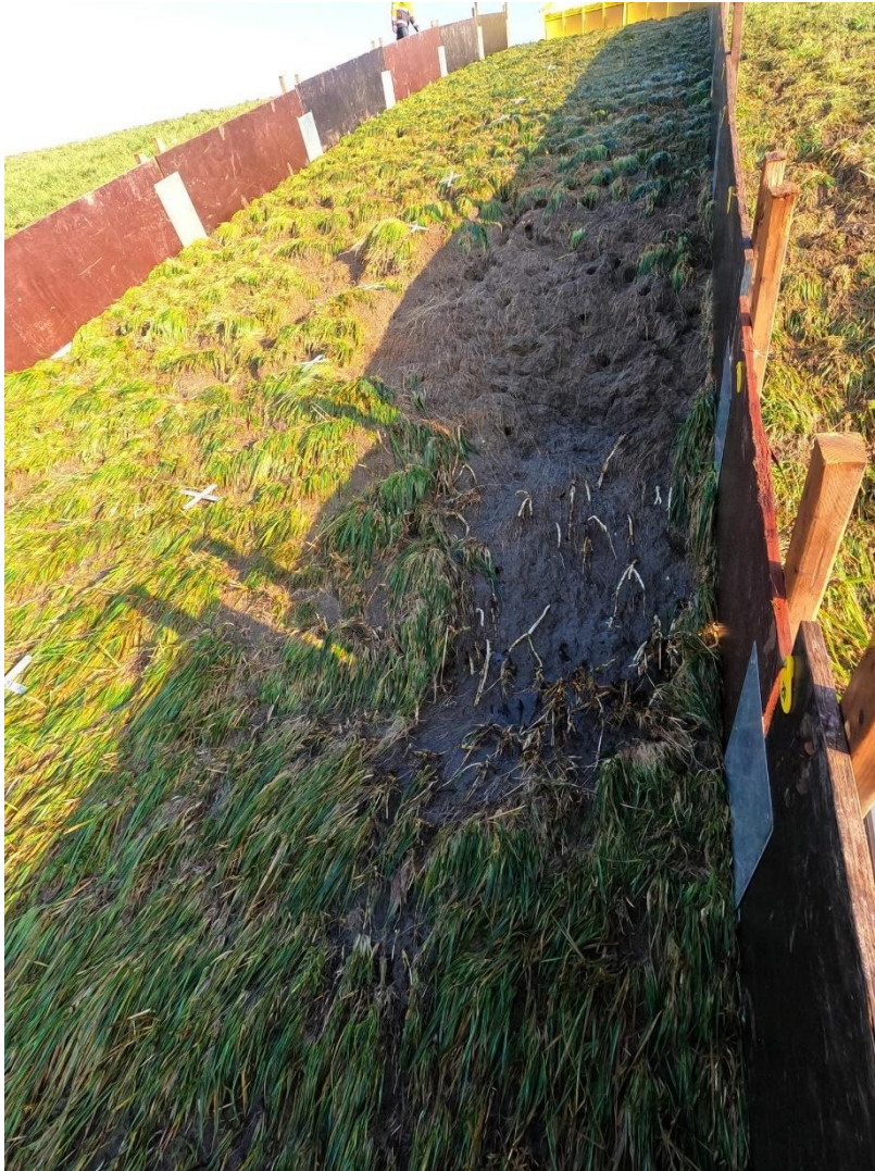
Figuur 18: Schadebeeld vakken 16-20CD na circa één stormuur met proef 2m100lsm
