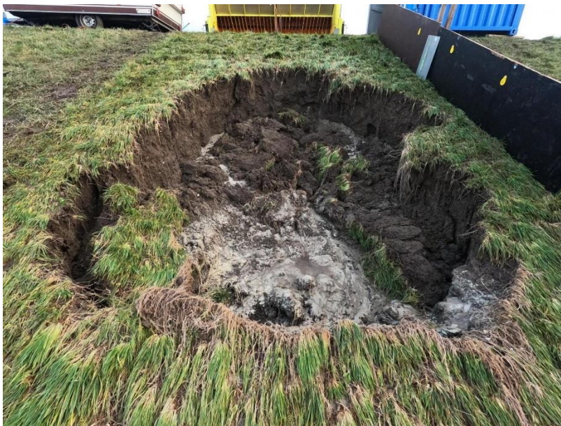
Figuur 35: Erosiegat einde proeven teststrook 3
