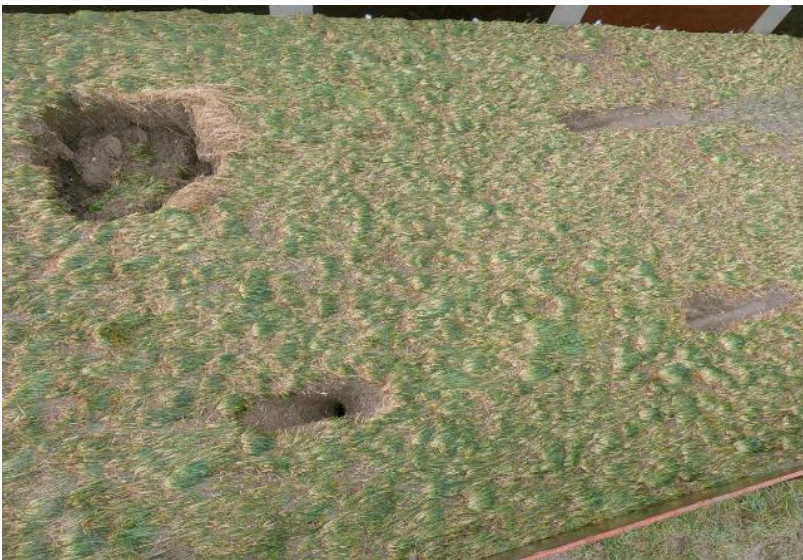
Figuur 33: Het talud ter plaatse van de aangebrachte schade in vak 7C zakte ineens in.
