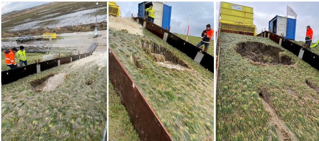
Figuur 34: Ontwikkeling erosie na ontstaan erosiegat in vak 7C. Rechts is de schade na circa 30 minuten storm met proef 1m190lsm te zien
