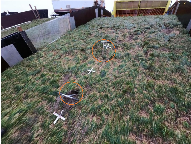
Figuur 24: Aangebrachte schade met grondboor in vakken 8 en 9.
