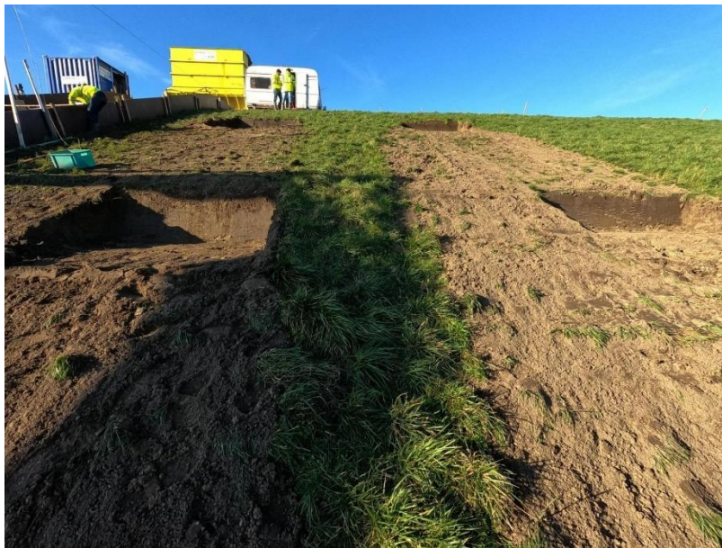
Figuur 45: De vier met de long reach kraan aangebrachte schades voor de Levee Challenge. De schades zijn circa 2 \times 2 \text{ m}^2 . Bij de onderste gaten is de hoogte van de verticale wand circa 70 cm. De verticale wand van de bovenste gaten is circa 80 cm hoog.
