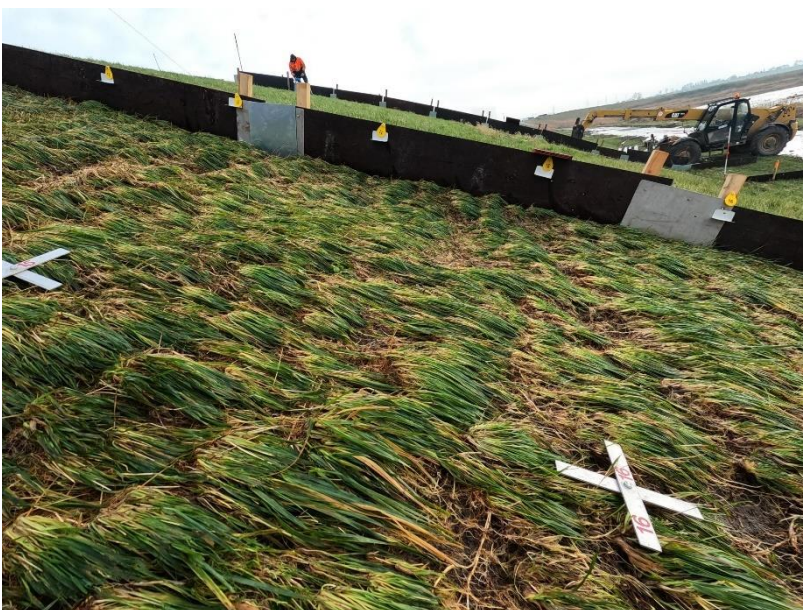
Figuur 13: Talud in vak 15CD lijkt aan het einde van proef 2m50lsm iets in te zakken.
